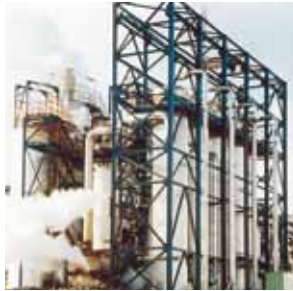
Estación de evaporación, Evaporadores de película descendente - 11600 m 2
